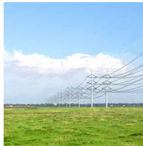
Wintrackmast met vier circuits met vier 380 kV-verbindingen.
